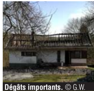
Dégâts importants. © G.W.
